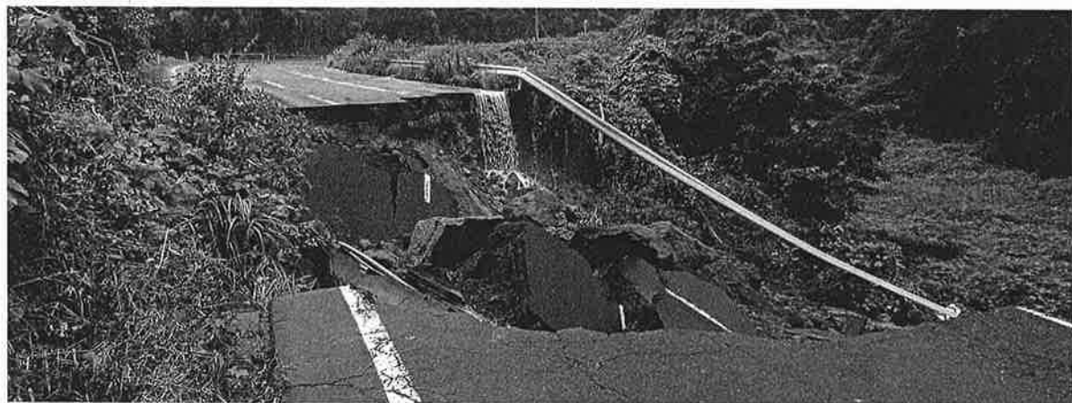
柳井玖珂道路被災状況を視察 西日本豪雨災害
