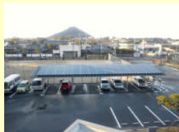
太陽光パネル
