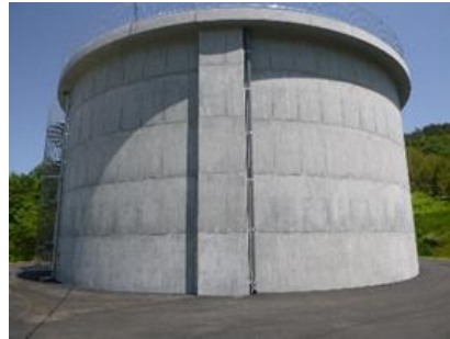
ファームポンド (PCタンク)
