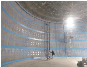
ファームポンドの内部
