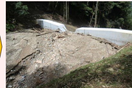
② 溪流崩壊発生後
