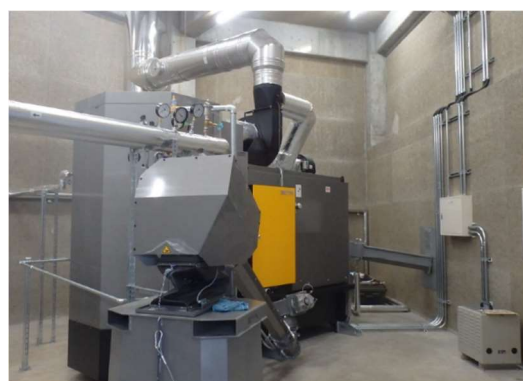
木質資源利用ボイラーの整備（美祢市）
