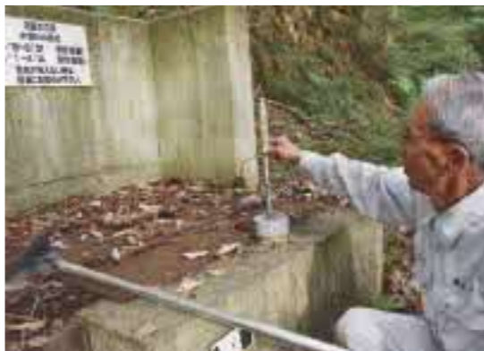
ちょうど取水口から水が運ばれて4km地点辺りで、パイプラインのなかを水が流れているか確認できる箇所がある。下に発砲スチロールの浮きをつけた棒（筆の柄の再利用）を水路に浮かべてあり、この棒の目印の位置によって、パイプ内の水の深さが外からわかる仕組みだ。水の深さは15〜19cmのところが良い。このアイデアも安村さんによるもの
