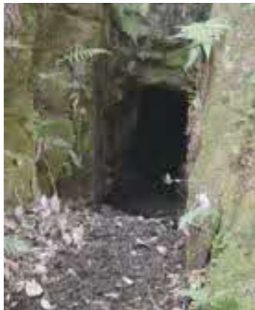
黒谷池側より向かった隧道の出口。岩盤を手掘りで削ったあとがはっきりわかる。作業しやすくなるためか、出口周りの空間も掘ってあった
