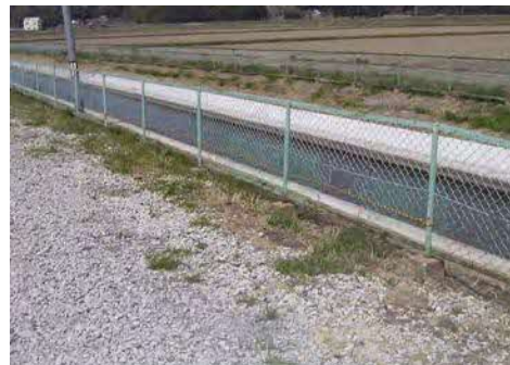
防護柵破損箇所
