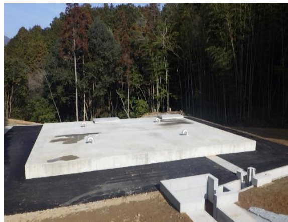
(代替水源施設 [貯水槽])
